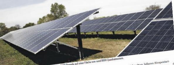
Das erste Wiener Bürgerkraftwerk in Donauwörth: 2100 Paneele auf einer Fläche von rund 6000 Quadratmetern.
